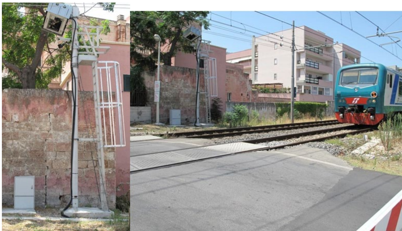
Figura 4 - Sistema PAI PL installato
