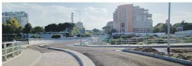
PICONE La bretella che collega via Cotugno al ponte Solarino (foto Doreto Fessano)
