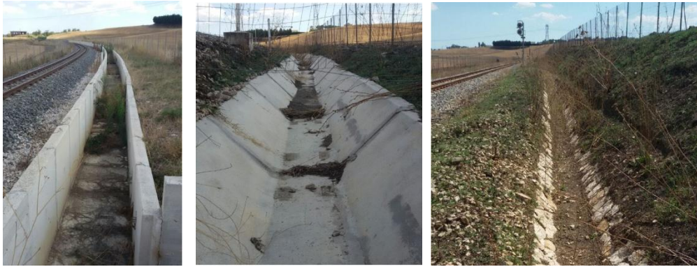
Foto 9 - Canalette esistenti per Raccolta Acque a Lato Binario
