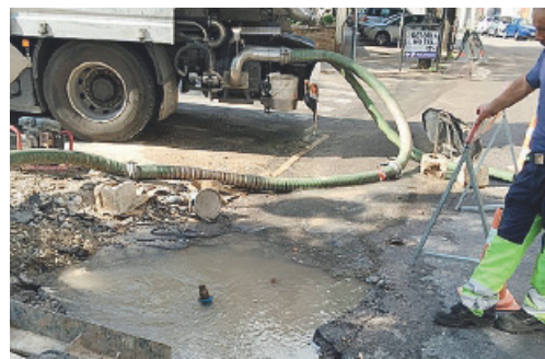
VIA MAZZINI La copiosa perdita di acqua
