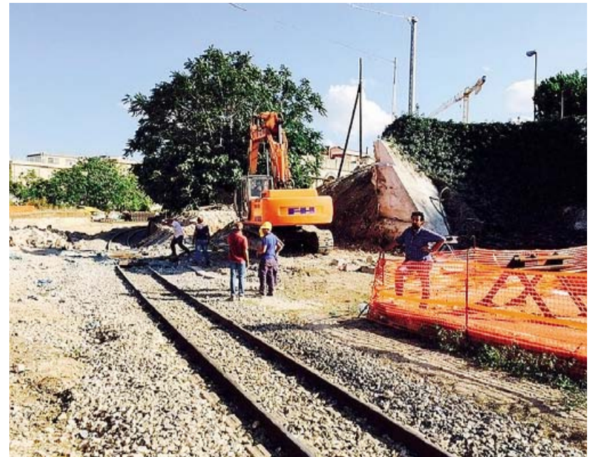
CANTIERE I lavori per l'abbattimento del ponte in via Pietrocola a Modugno
