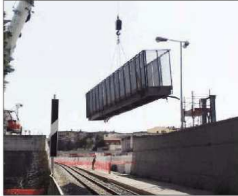
I lavori del nuovo tunnel di collegamento al Terminal bus di Serra Rufusa
